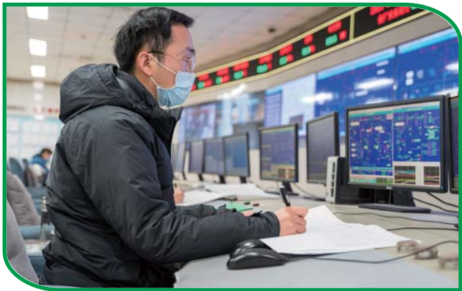
集控室运行人员在认真监盘。
