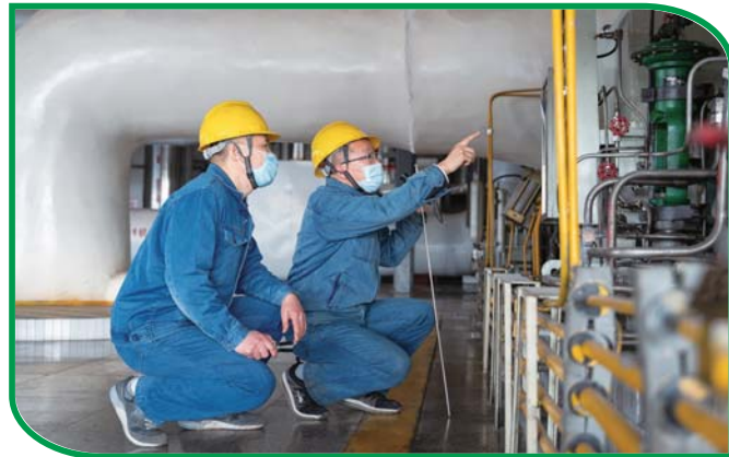
运行人员巡检供热设备。
