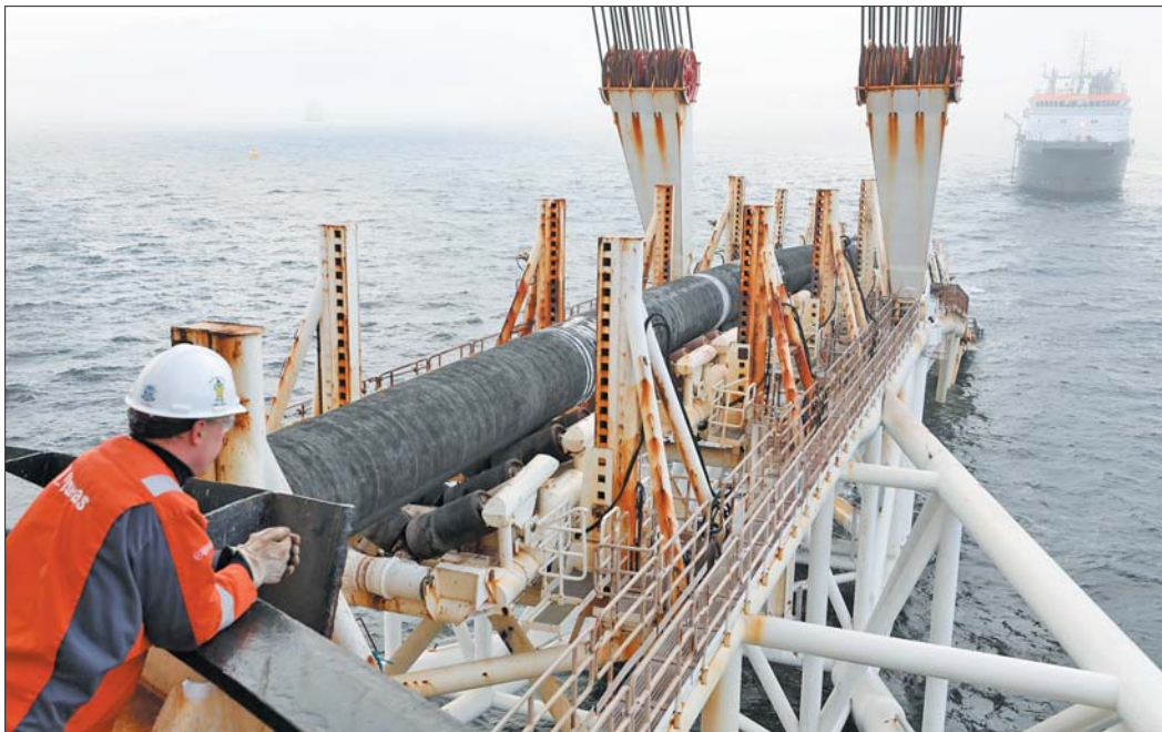
在德国拉格附近的波罗的海水域,一名工人在“北溪-2”天然气管道项目铺管船上工作。 新华社资料图
