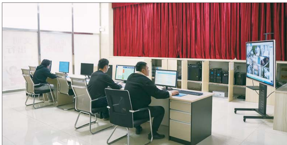
智能监控中心大屏幕上实时显示参数情况。
