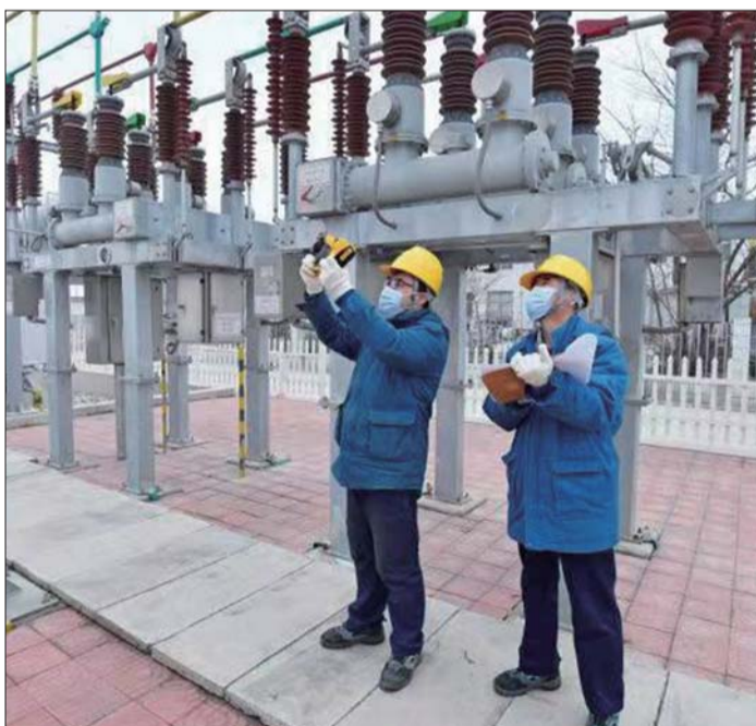
国网曲阜市供电公司工作人员对35千伏书院变电站设备进行红外测温。
