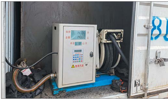
改装厢式货车里的储油罐和加油机。
