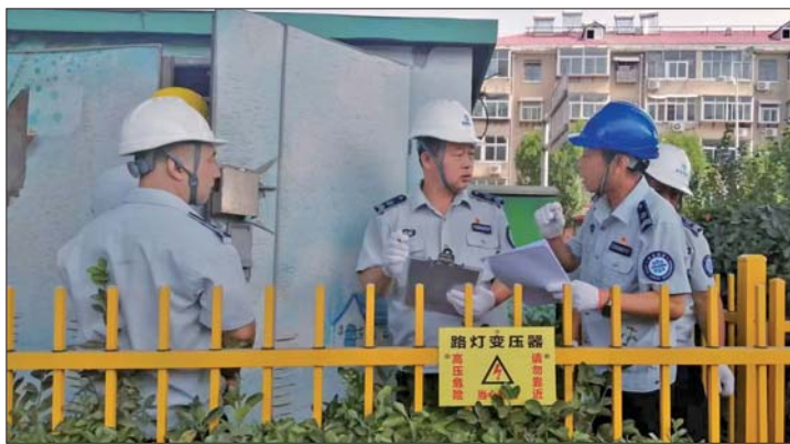
工作人员进行变压器巡检。
