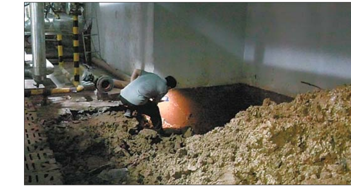
居民前来查看换热站里挖开的土坑里积水情况。
