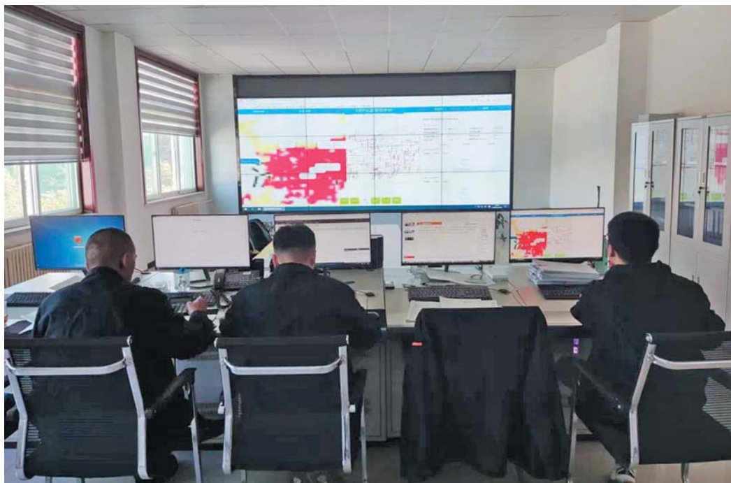
调度中心是供热运行监控的“神经中枢”。
