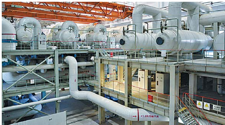
厂供热中心站
