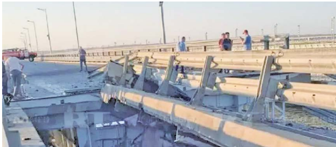
受损的克里米亚大桥（视频截图）
