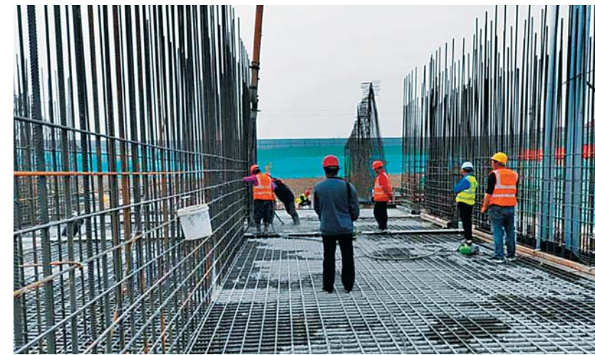
徒骇河故道拦蓄引水工程施工现场,工人们加快进行生产桥作业施工。
