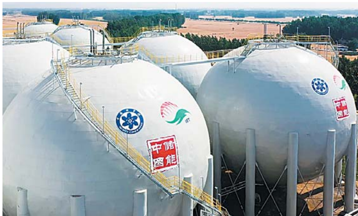
近日，山东肥城300MW先进压缩空气储能国家示范项目并网发电。
