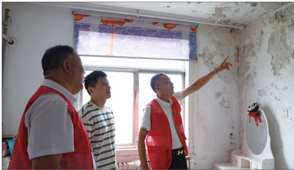
实地走访查看居民房屋漏水情况。
