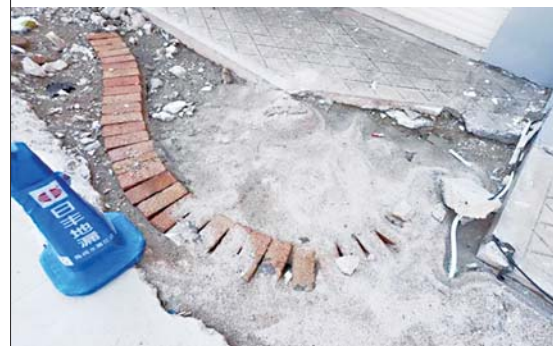
挖断的电缆已被掩埋。
