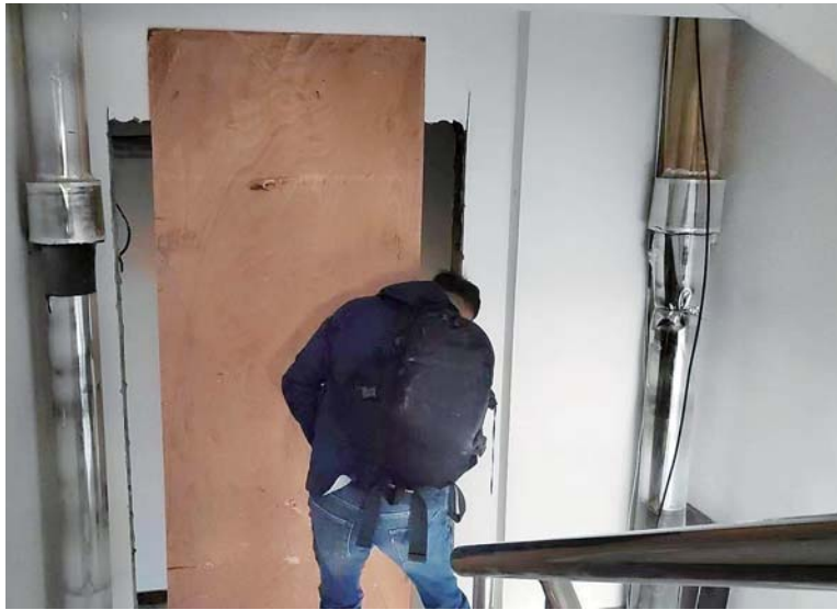
业主称，商户自在楼道墙上开了一道门，只用一块木板简单挡着。
