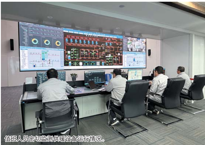
应对寒潮天气，东泰热力全力保障供热安全稳定运行。
