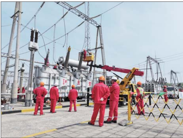
220千伏变电站检修作业现场,各项工作有序推进。 通讯员 张金硕 摄
