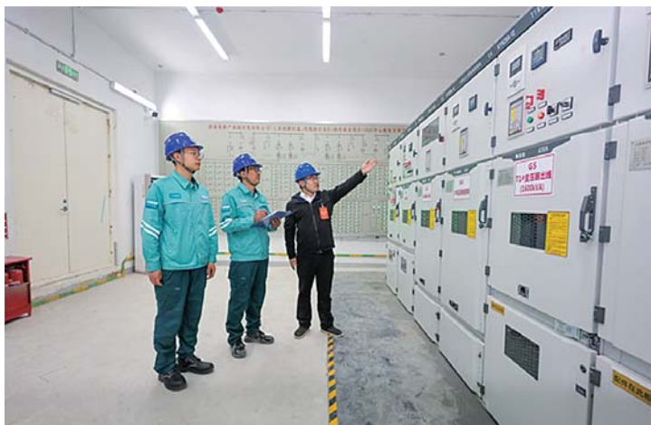
济南供电公司员工到山姆会员商店济南高新店，协助客户检查配电室设备运行情况。
