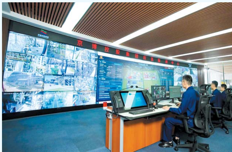
京博控股中控室，生产数据实时跳动，自动化控制系统高效运转。
