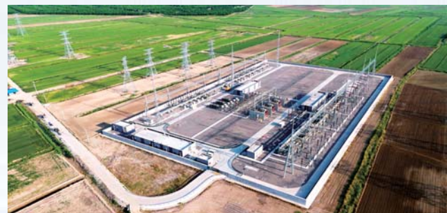
500千伏弥河变电站
