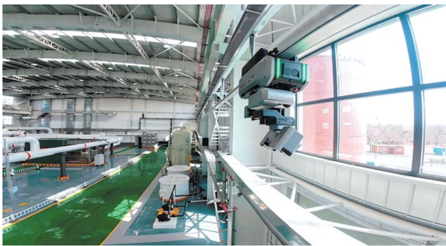
全国首座实现“黑灯模式”运行的供热中继泵站。
